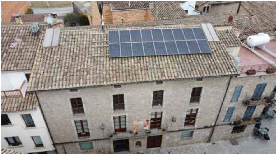
Instal·lació Fotovoltaica a la teulada de l'ajuntament d'Olost. 2022
